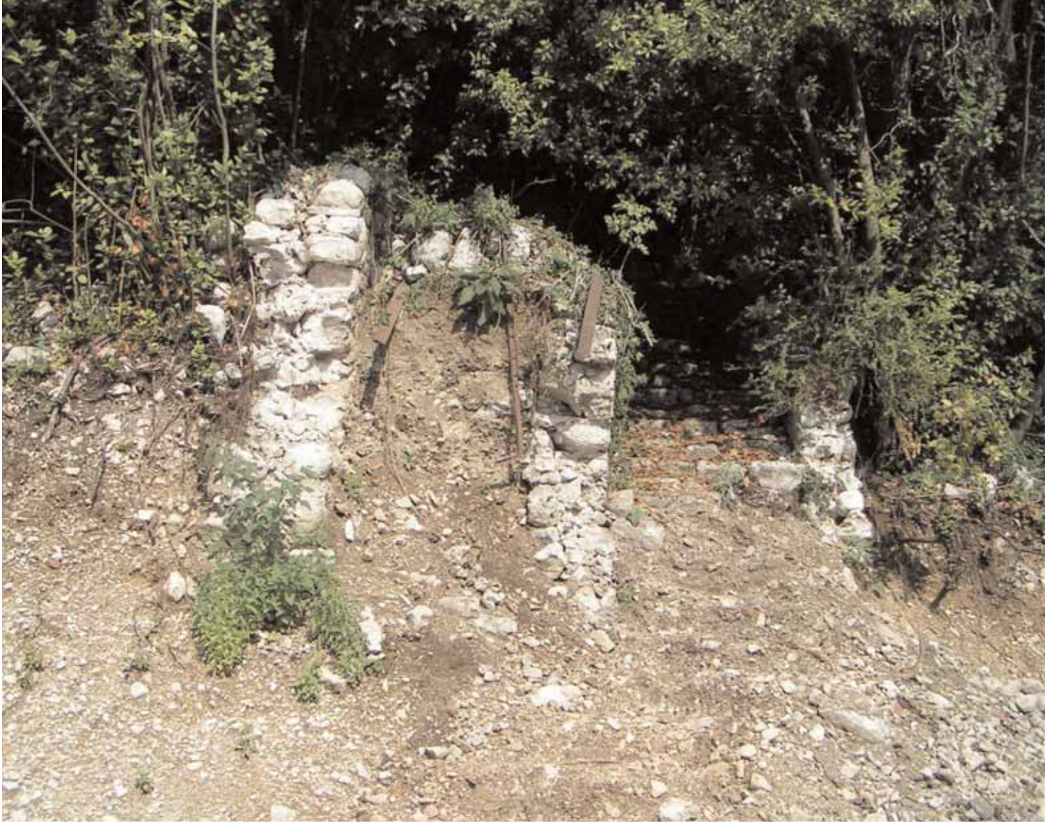
Le vecchie mura di Gemona con scalinata danneggiata dai lavori - 11/09/2005
