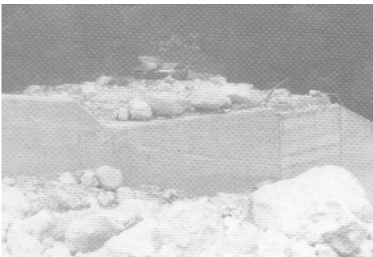
Figura 6 - Ponte travolto dalla colata detritica del giugno 1987, che ne ha asportato completamente l'impalcato. Il franco di sicurezza era stato dimensionato considerando solamente la portata liquida del torrente..
